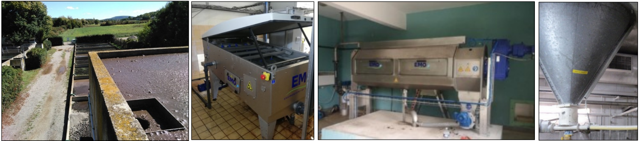
Figure 10 : Silo de stockage de boues et lits de séchage non plantés (Source Agrosylva)
